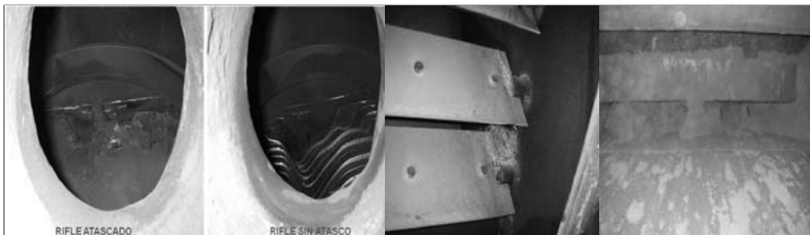
Figura 7: Atascos producidos en los rifles de los quemadores y en los clasificadores. (Fuente: Elaboración propia).
